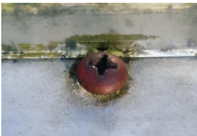
Begyndende nedbrydning ved en selvskærende skrue i drivhusets bundstykke.
