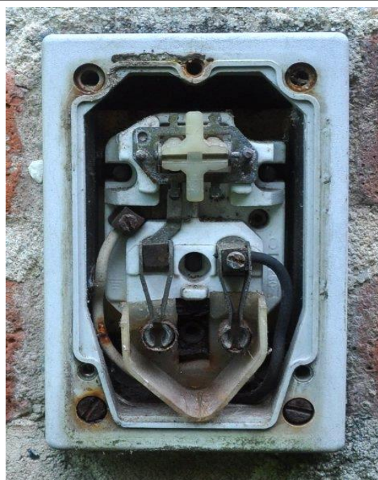
Eksempel på en udvendig stikkontakt hvor jordkontakten er eroderet bort som følge af indtrængende vand.
